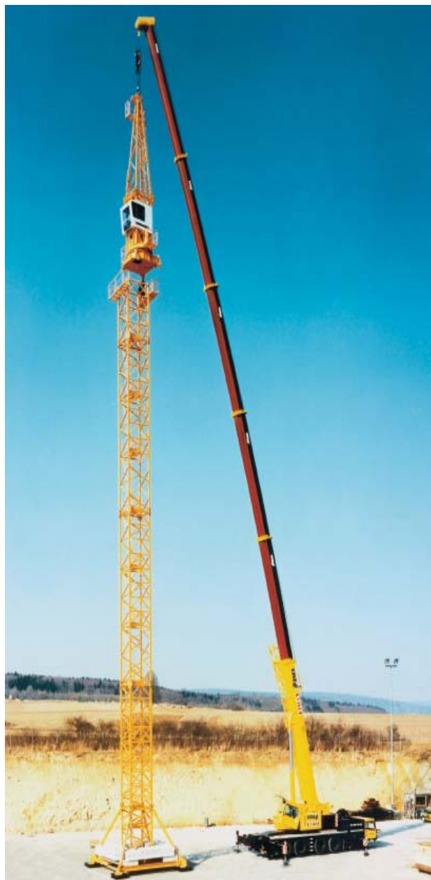
Bild 23: Mobilkran bei der Montage eines Baukranes (Bild mit freundlicher Genehmigung der Liebherr-Werk Ehingen GmbH, Ehingen)
